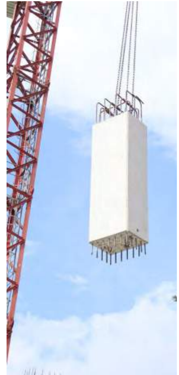
▲ Con la implementación de las columnas prefabricadas incrementamos la productividad disminuyendo el tiempo de ejecución de 24 a 2 horas. Contree Palmas, Medellín.
