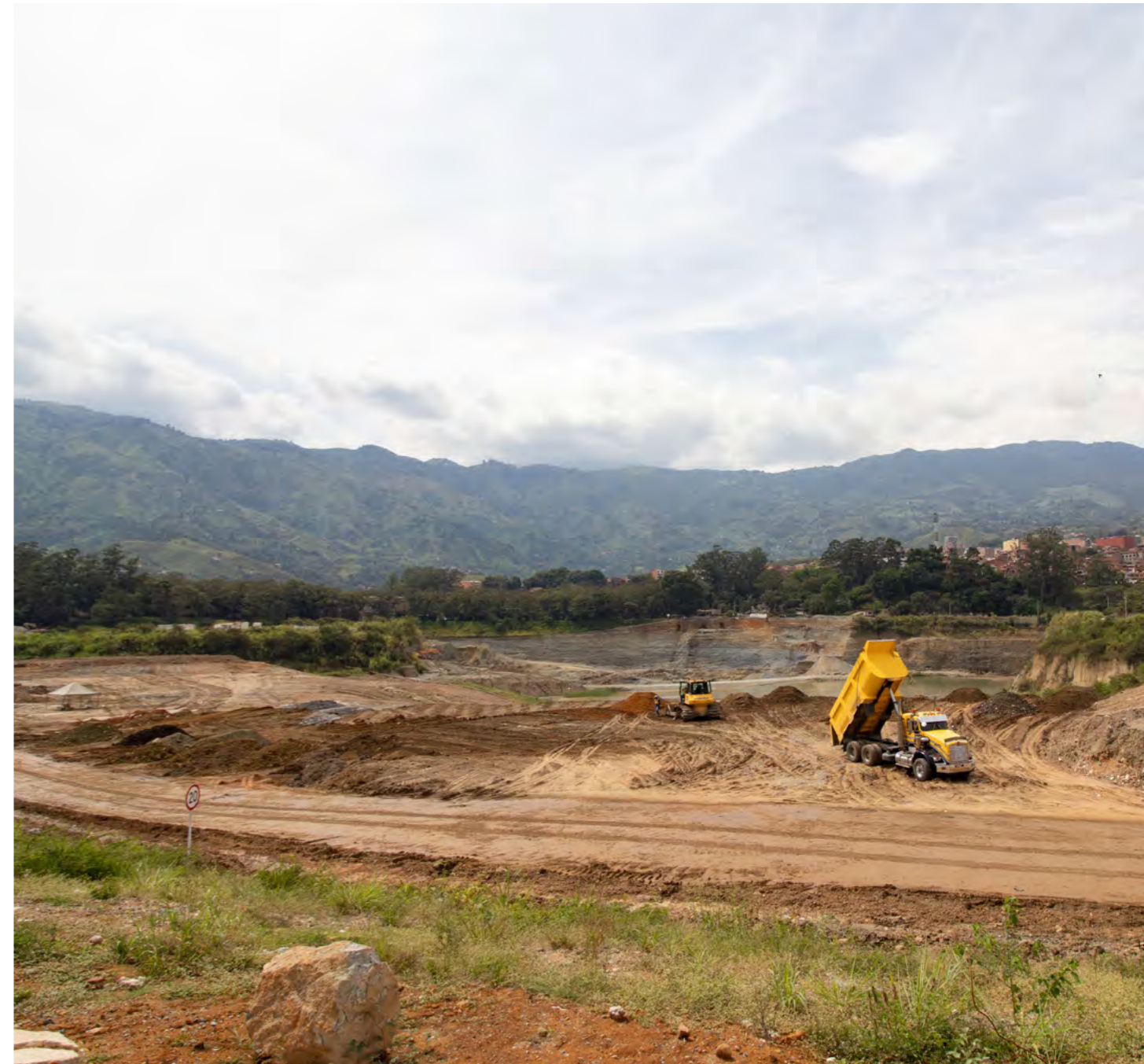
▲ Planta de Producción de Agregados. Girardota, Antioquia.
