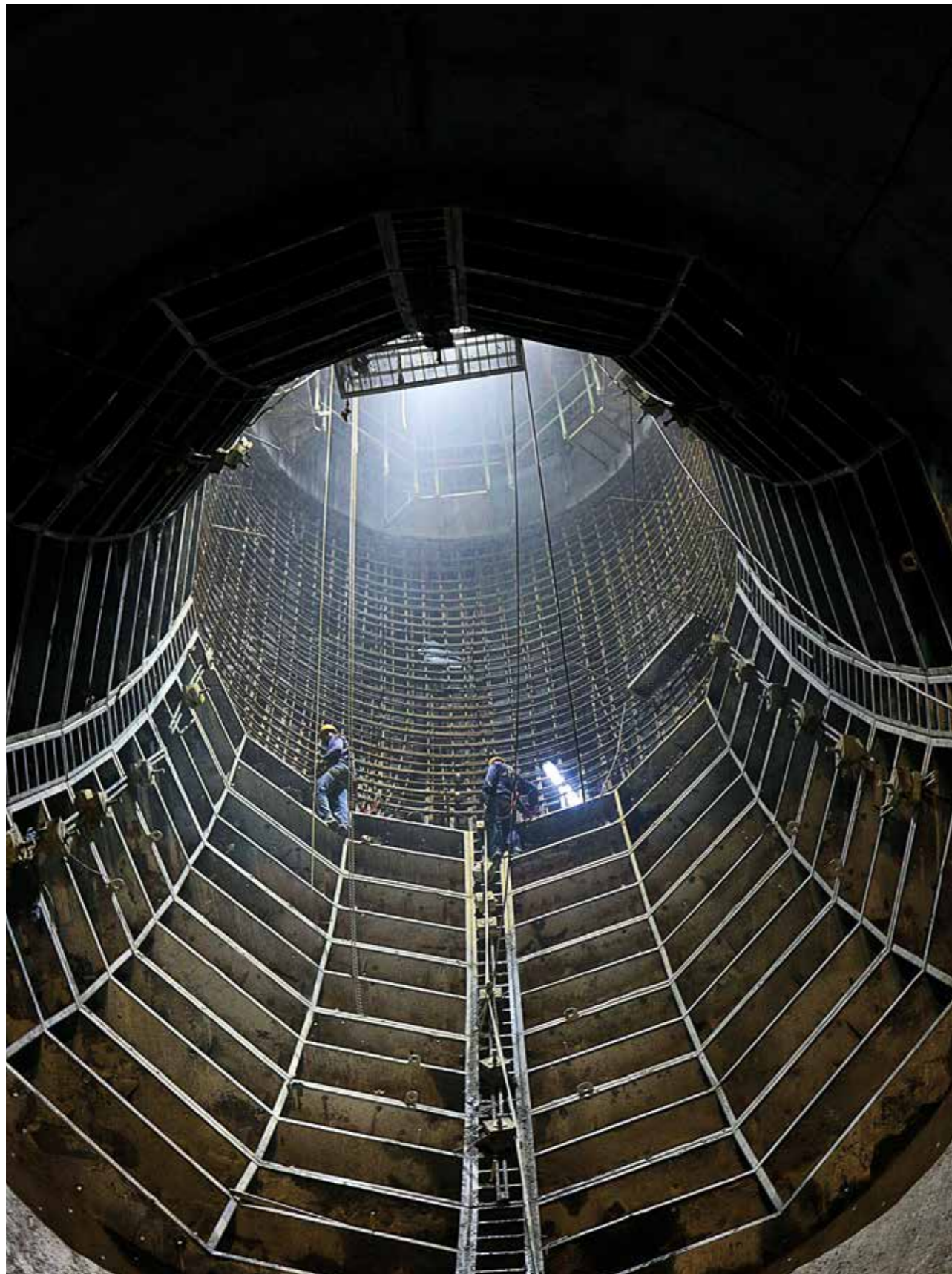
Codo inferior de conducción. Hidroituango, Antioquia. Obra construida en consorcio para EPM.
