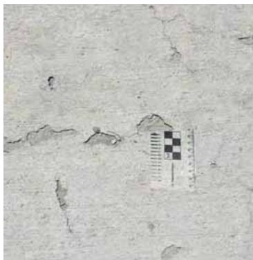
Figura 12.4. Agrietamiento plástico en un pavimento de concreto, debido a una rápida pérdida de humedad en la superficie y exudación †
