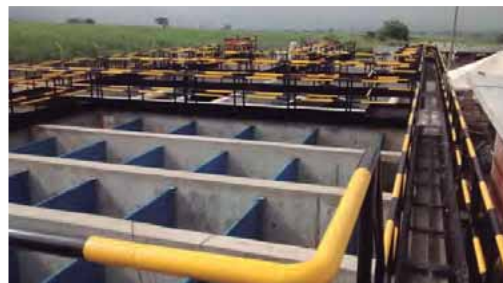
Figura 6.3. Planta de tratamiento de agua potable sujeta a la acción de cloruros y sulfatos Planta de tratamiento regional del norte, Cauca Cortesía de Constructora Conconcreto
