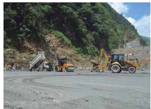
Figura 9.6. Transporte, manejo, colocación y compactación del CCR en preatagüa del proyecto hidroeléctrico Ituangó (Cortesía Constructora Conconcreto)
