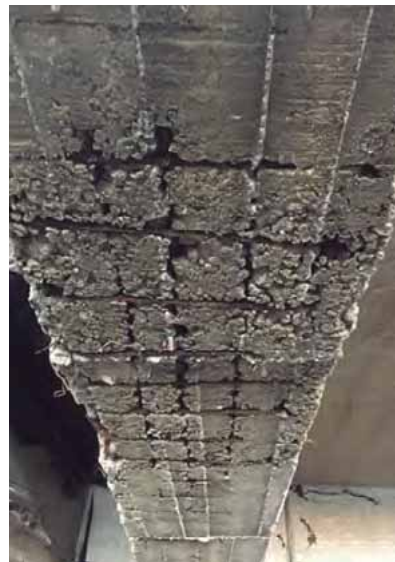
Figura 5.1. Aspecto de concretos con excesivo aire atrapado por mal vibrado ‡
