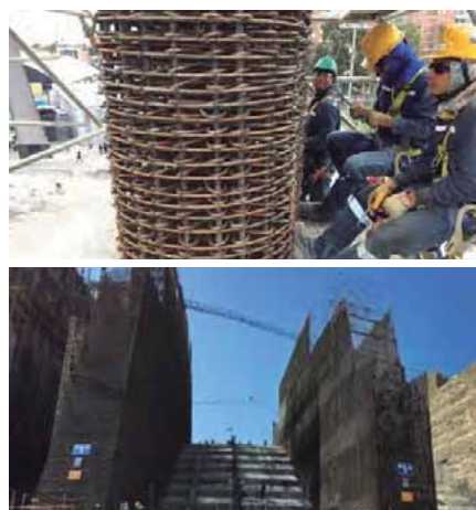
Figura 6.1. Estructuras de difícil colocación y compactación del concreto Arriba, columna en una edificación. Abajo, pilas y veredero en hidroeléctrica ituango (Obra de Constructora Conconcreto, Coninsa y Camargo Correa)
