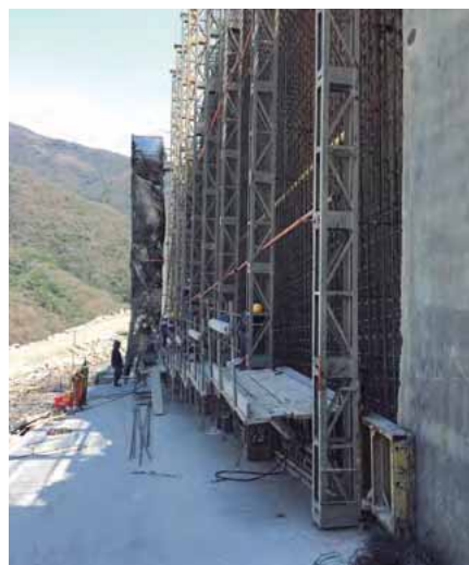
Figura 11.32. Detalles de formaletas para concreto deslizado, Proyecto hidroeléctrico Ituango Cortesía Constructora Conconcreto
